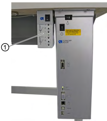
(1) - Transformator pentru lumina de cusut
