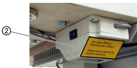
Fig. 45: Conexión de las luces de costura del transformador de la iluminación del área de costura (2)
